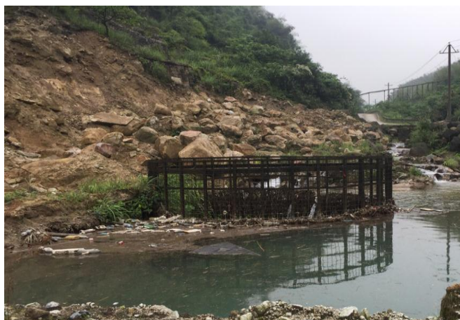
图 2-8 排水竖井堵塞
