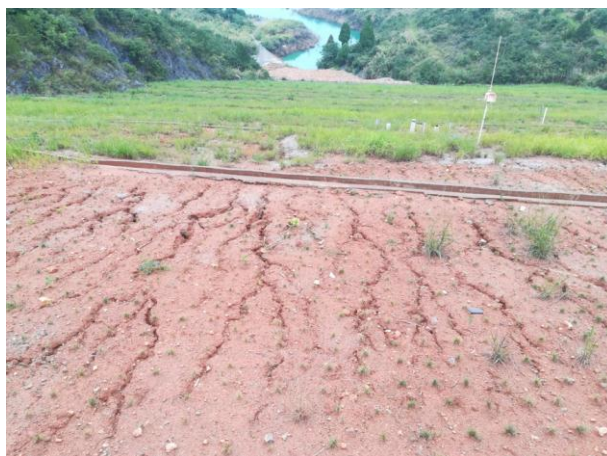
图 2-5 坝体外坡出现冲刷、拉沟现象
