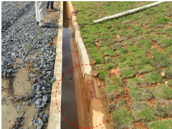
图 2-10 浸润线从堆积坝坡逸出
