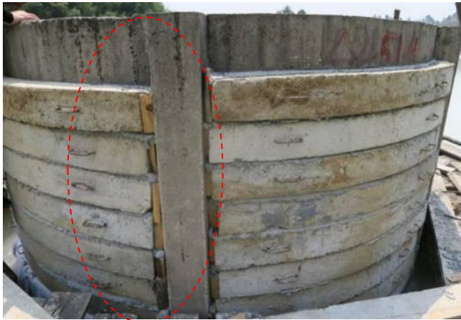
图 2-7 排水井拱板与立柱之间未严丝合缝
