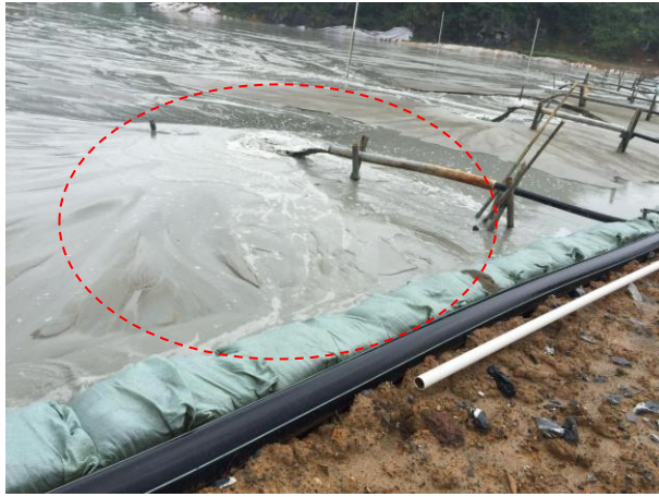
图 2-3 尾矿回流冲刷子坝坝体
