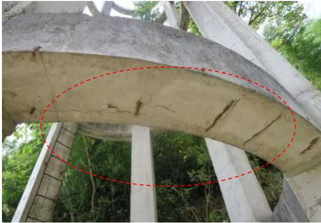
图 2-9 排水井钢筋裸露
